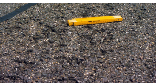
Typisches Bild eines schadhaften Asphaltbelags
